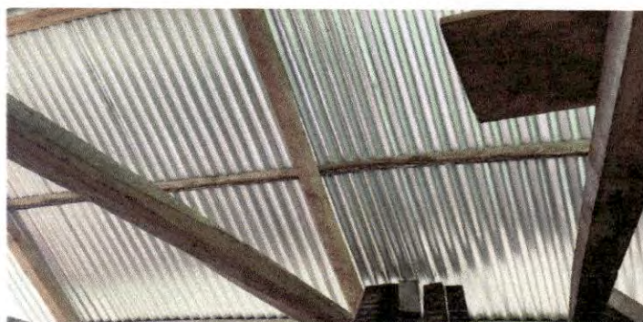
Foto 10: Lamina en malas condiciones.
