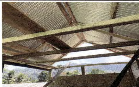
Foto 2: Vigas de madera no adecuadas.
