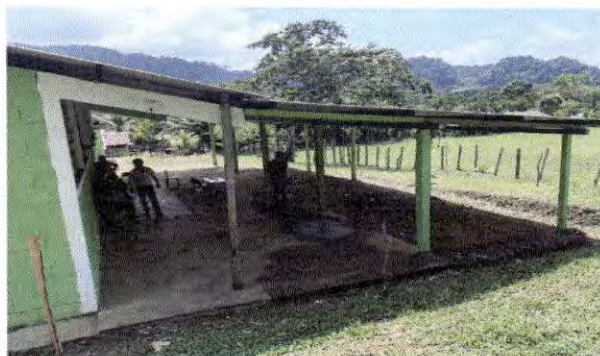
Foto 4: estructura de lamina en mal estado
