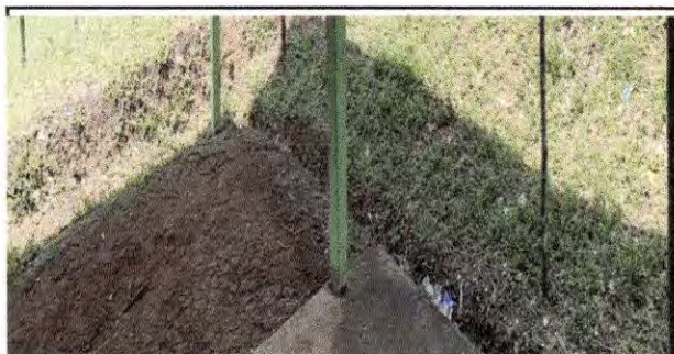
Foto 3: columna en mal estado y sobrepuesta.
